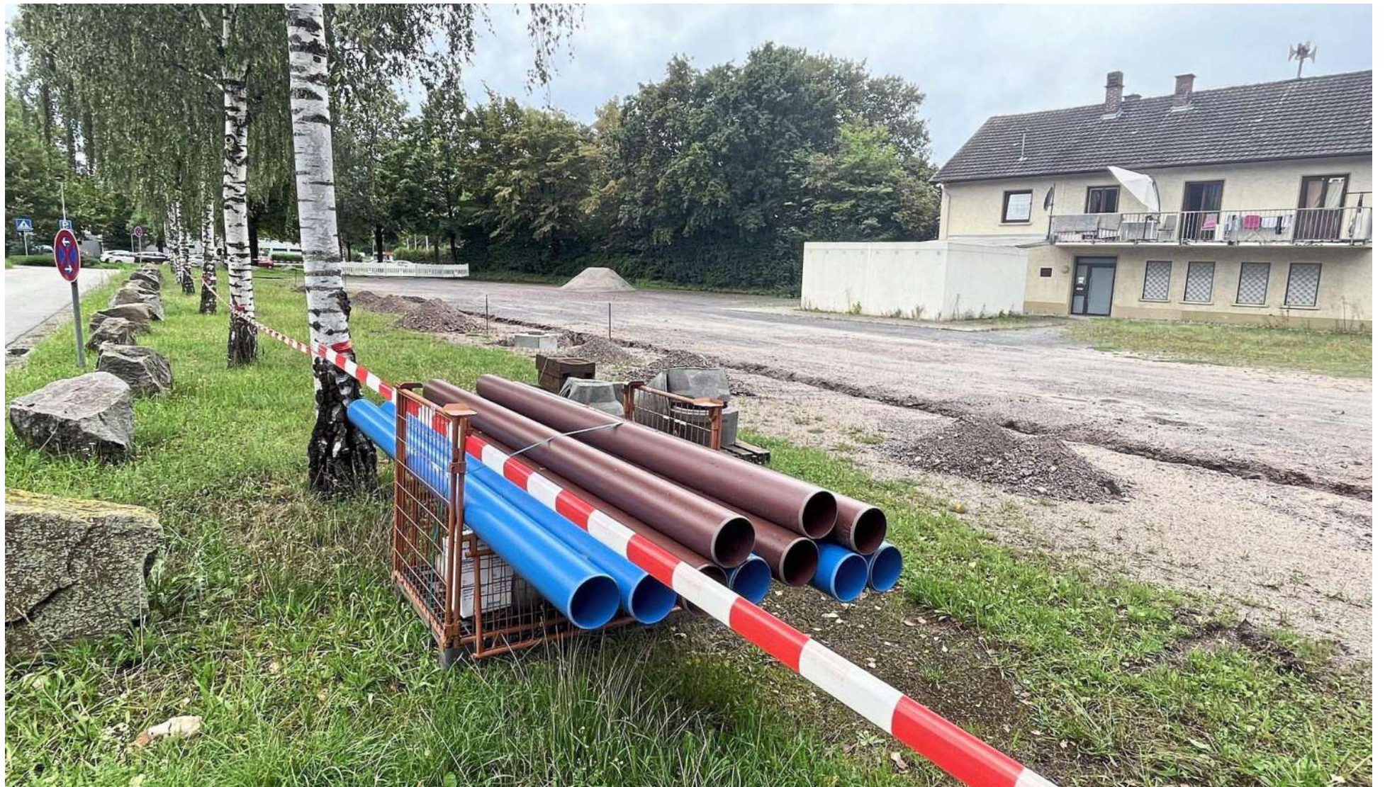
Die Bauarbeiten für den neuen Wohnmobil-Stellplatz in Bühl haben erst kürzlich begonnen. Diese sorgen für Unmut bei Besuchern des Schwimmbads.
